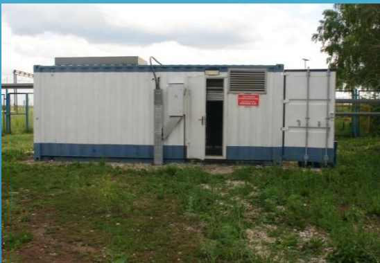
Азотная установка АДА-0,100
